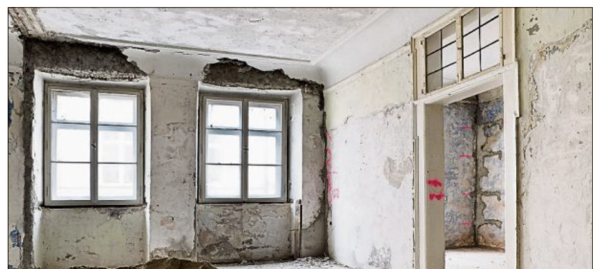
die vor der Sanierung schon ziemlich übel aussahen.
